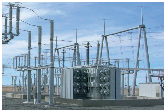
Рис. 2.30. Силовий трифазний трансформатор
